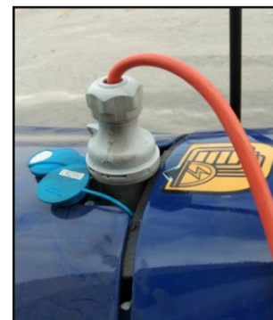
RCD Oplaadkabel ingestoken
